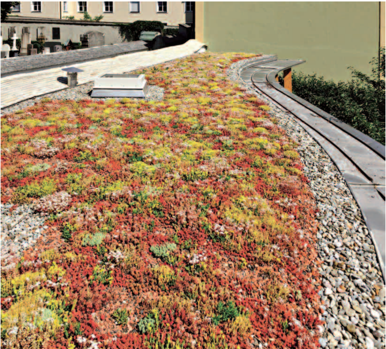
Bild 5: Extensiv begrüntes, rollennahtgeschweißtes Flachdach aus Edelstahl Rostfrei, Werkstoff: 1.4404 (Foto: Binder und Sohn GmbH, Ingolstadt)
