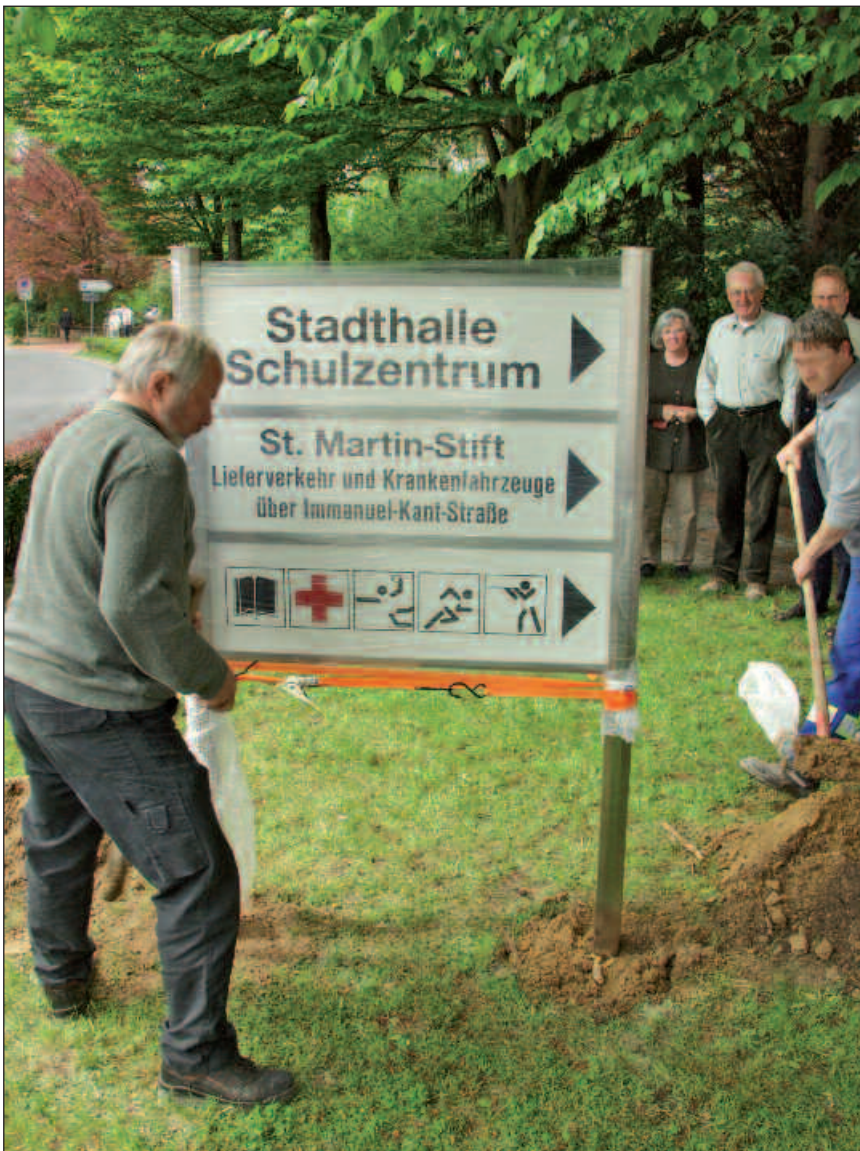
Bild 2: Die Edelstahlprofile sind mit Fundamenten im Erdreich verankert, Werkstoff: 1.4301 (Foto: Wilhelm Modersohn GmbH & Co. KG, Spenge)
