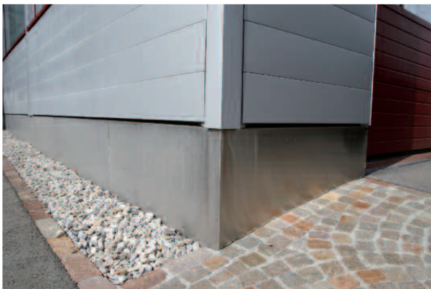
Bild 7: Sockelbereich aus nichtrostendem Stahl im Bodenanschluss, Werkstoff: 1.4301 (Foto: Roofinox GmbH, Sulz (A))
